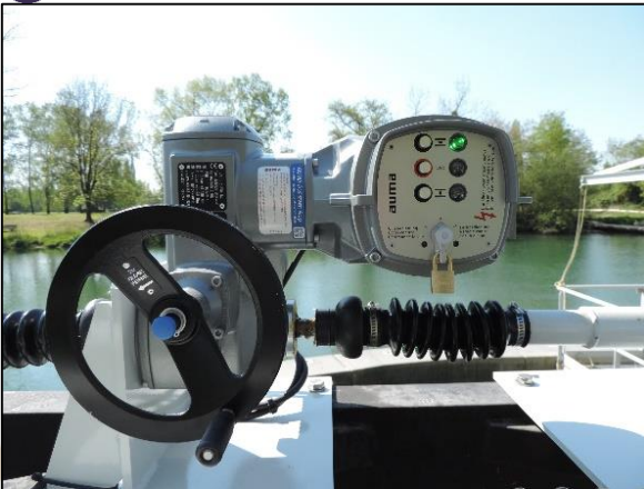
✓ Motorisation de la vanne
