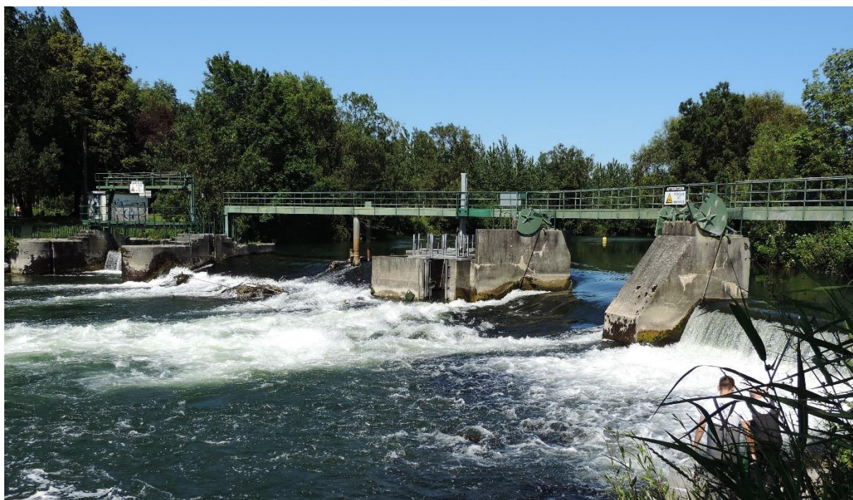
Figure 42 : Le barrage de Crouin (17/06/2019)
