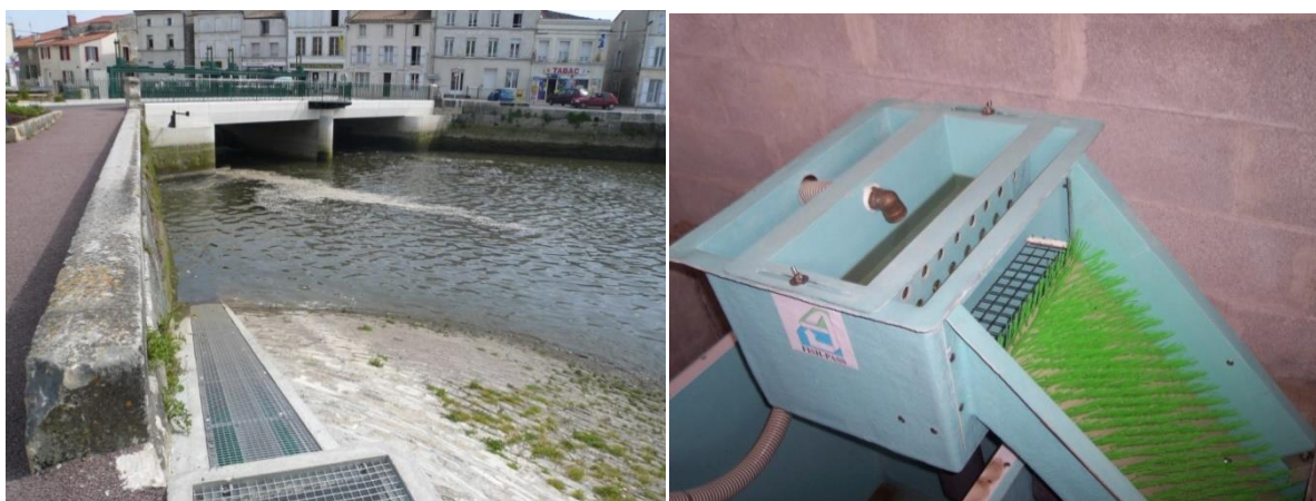
Figure 62: Photos de la passe piège anguilles de Saujon (brosse extérieure sous grille et piège)
