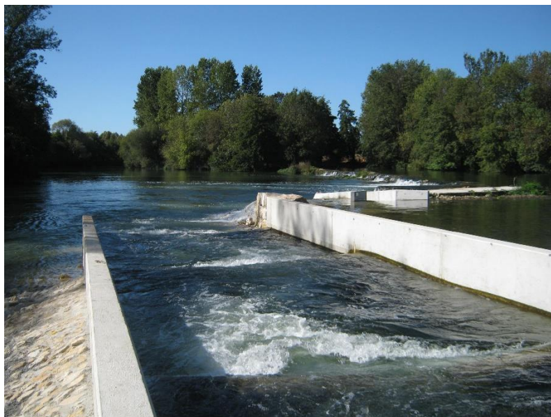
Figure 140: Passe à poissons de Juac, en eau, le 12 octobre
