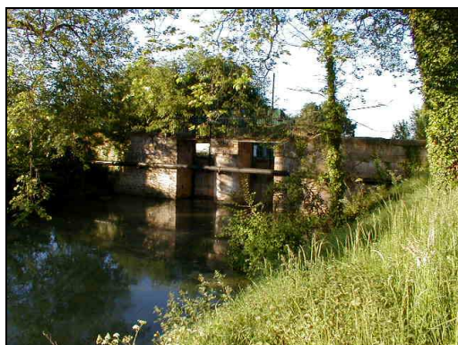
Les vannes de Charras et de Ciré-Larocque représentent des obstacles majeurs et conditionnent largement la colonisation du marais par l'Anguille.
