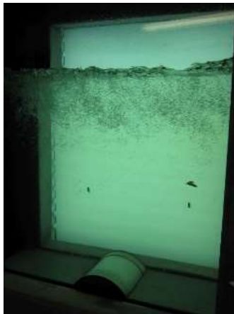
Nouvelle vitre posée : quelques micro fuites qui se sont colmatées à l'usage
