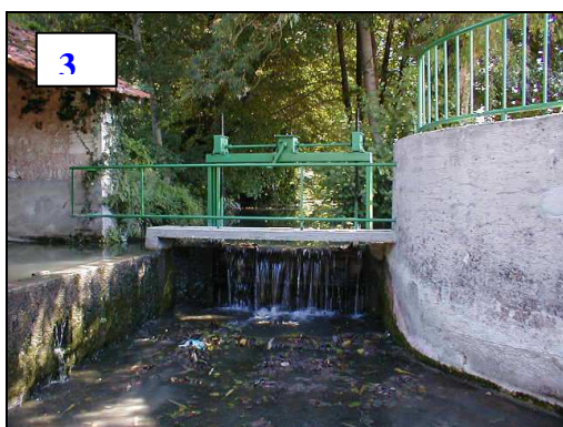
1- Clapet du barrage des 3 Pelles
