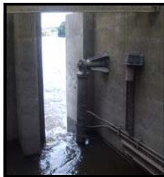
Vanne de prise d'eau asservie au niveau aval
