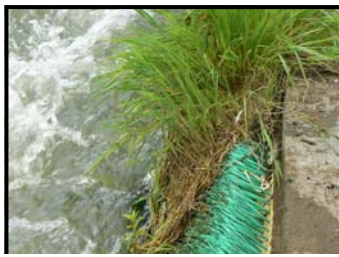
Développement excessif de végétaux sur un tapis brosses
