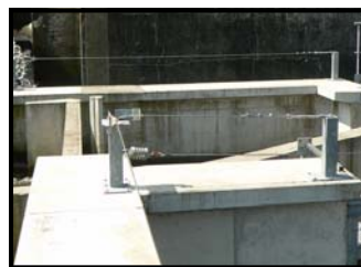
Filins métalliques entourant une passe à bassins
